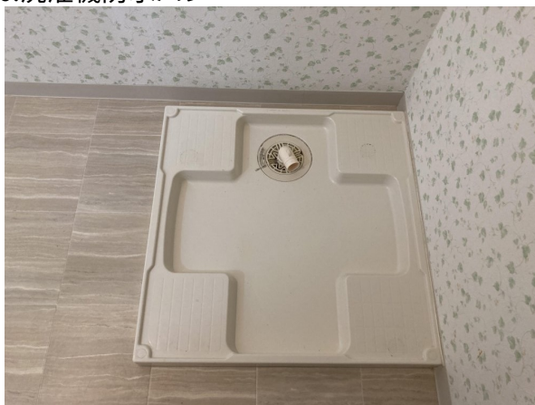
6.洗濯機防水パン
